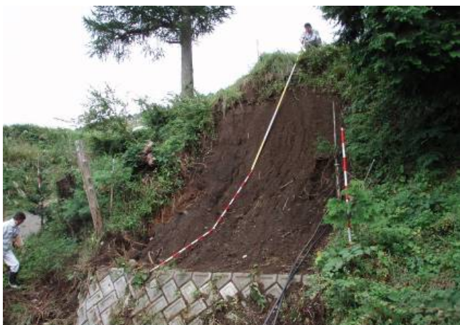
①豪雨により法面崩落した農地法面
