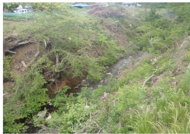
②未整備の用排水路 洗掘され農地法面が浸食している
