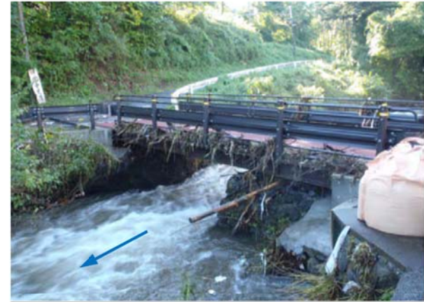
① 溢水後の状況 H23.9.22(台風15号)
