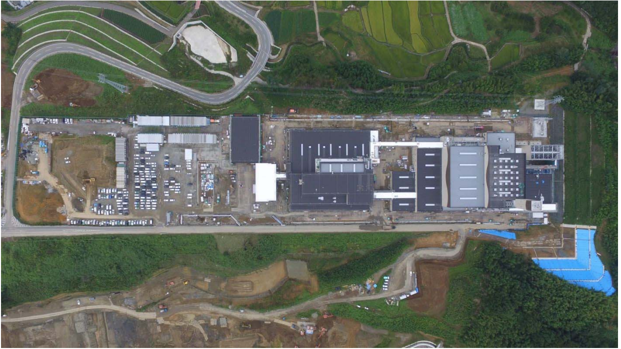
図 2-2-16(1) ごみ処理施設の工事進捗状況（全体 上空視点） 平成 28 年 9 月時点
