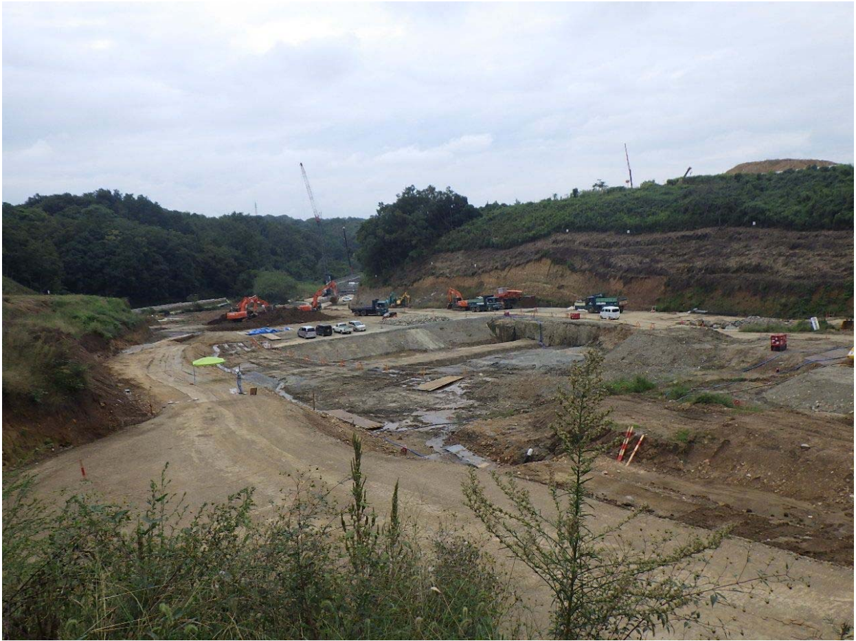
図 2-2-17(3) 最終処分場の工事進捗状況（埋立地 下流側） 平成 28 年 9 月時点
