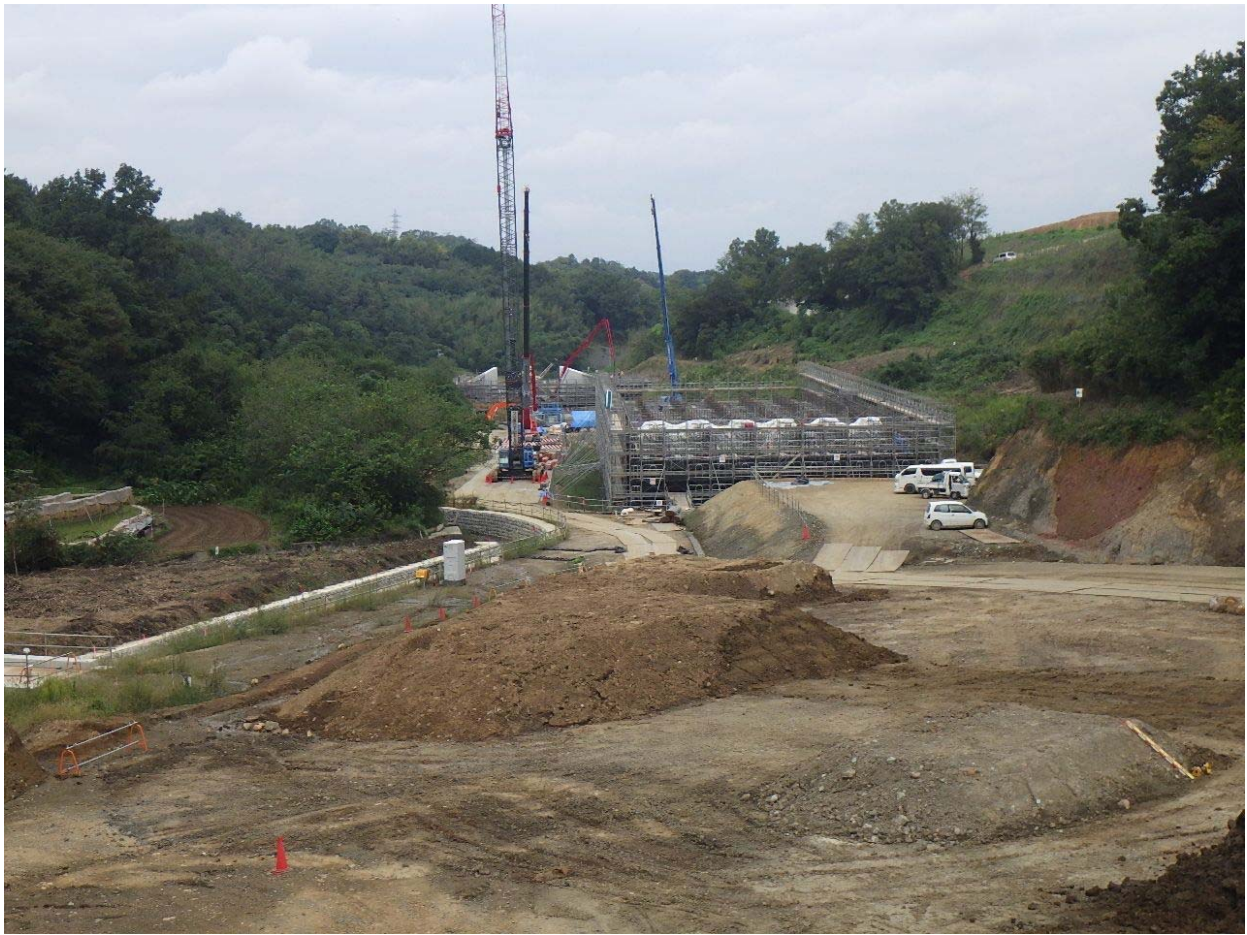
図 2-2-17(1) 最終処分場の工事進捗状況（浸出水調整池及び防災調整池） 平成 28 年 9 月時点
