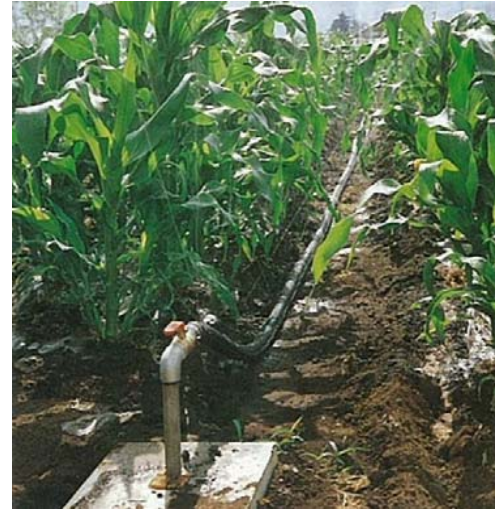
ほ場給水栓による灌水
