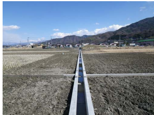
完成後 水路整備により安定した用水が確保されると共に、溢水による被害も防止されている。
