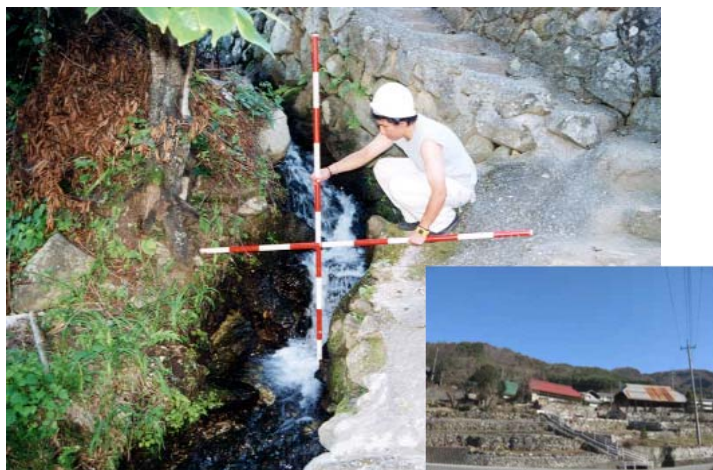
着工前 急傾斜地に石垣を設け平地を造り、集落が形成されているため、傾斜に伴う急勾配の水路は、洗掘や溢水などの被害が発生し、防災上の不安を抱えていた。
