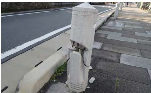
写真 4.1.151 破損した防護柵
