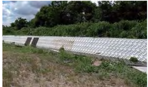
写真 3.22 周辺との明度差が大きい護岸
