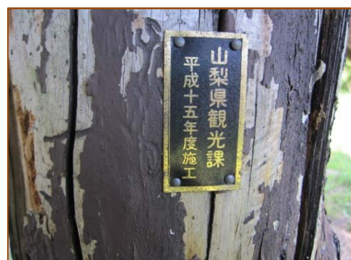
管理銘板が目立たない大きさや色彩で設置されている例。
