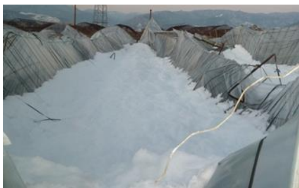
③谷部の積雪による倒壊
