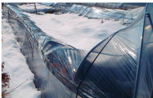
①アーチ部の陥没
