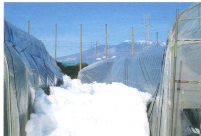
ハウスとハウスの間に落ちた雪による側圧で倒壊
