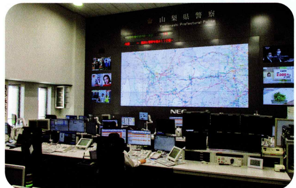
交通管制センター
