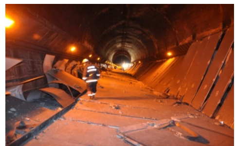
笹子トンネル天井板落下事故
