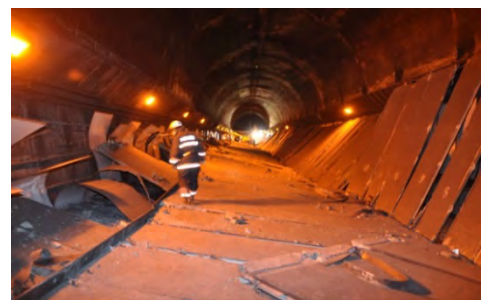
笹子トンネル天井板落下事故
