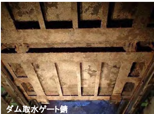
水門開閉装置の老朽化
