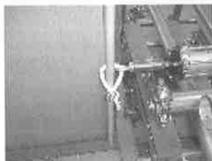
写真17 戸とエアシリンダーのつながり
