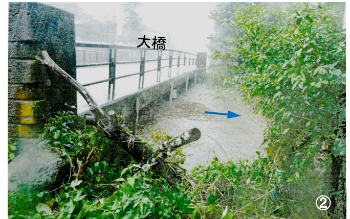
溢水状況 H23.9.21 (台風15号)
