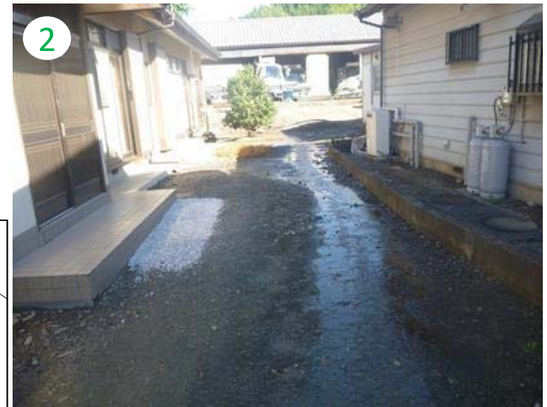
H26 漏水状況
