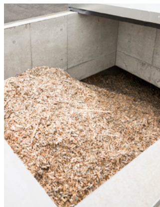
チップ庫には約10日分の木質チップが貯蔵され、自動的にボイラーに供給される
