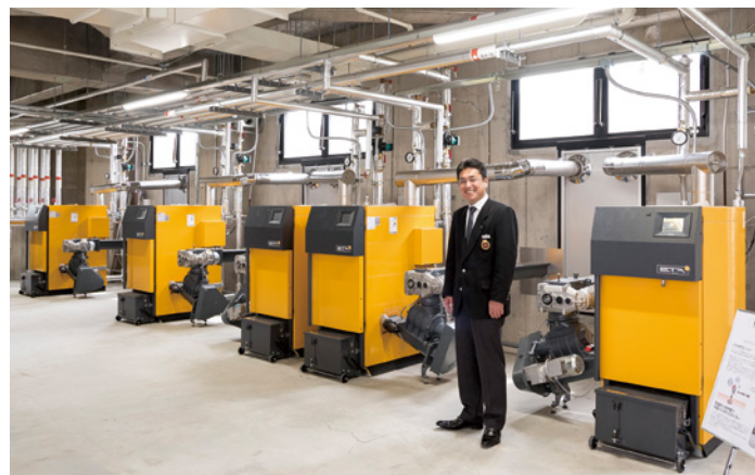
オーストリア製のボイラー5台で、クラブハウス内の入浴施設やレストランなどの給湯を賄っている
