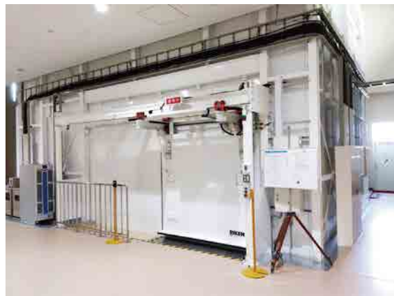
電波暗室（外観と EUT 搬入用シールド扉）
