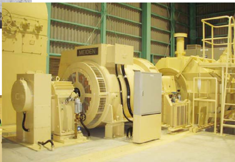
水車・発電機
