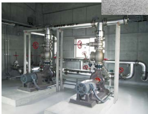
受湯室送湯ポンプ
