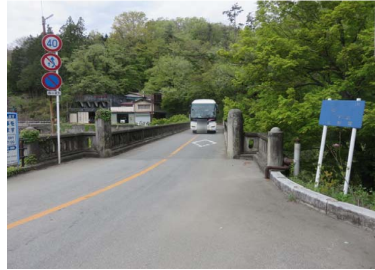
②現橋幅員状況（幅員狭小、歩道無し）
