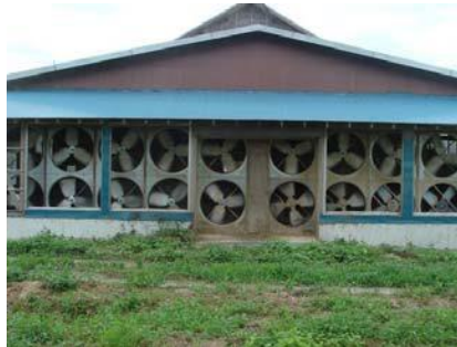
牛舎壁面の換気扇
