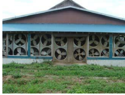
牛舎壁面の換気扇
