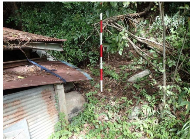
④斜面法尻 小屋背面に崩土堆積
