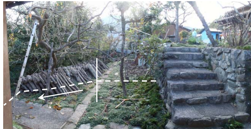
②頭部全景(急斜面頭部の遷急線、斜面肩部の沈下が明瞭)
