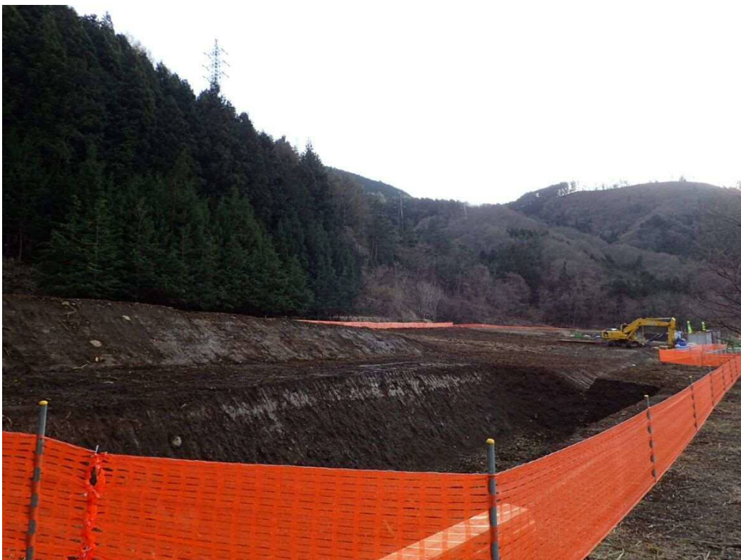
仮設沈砂池と仮設水路の写真（工事区域入口から西方向）
