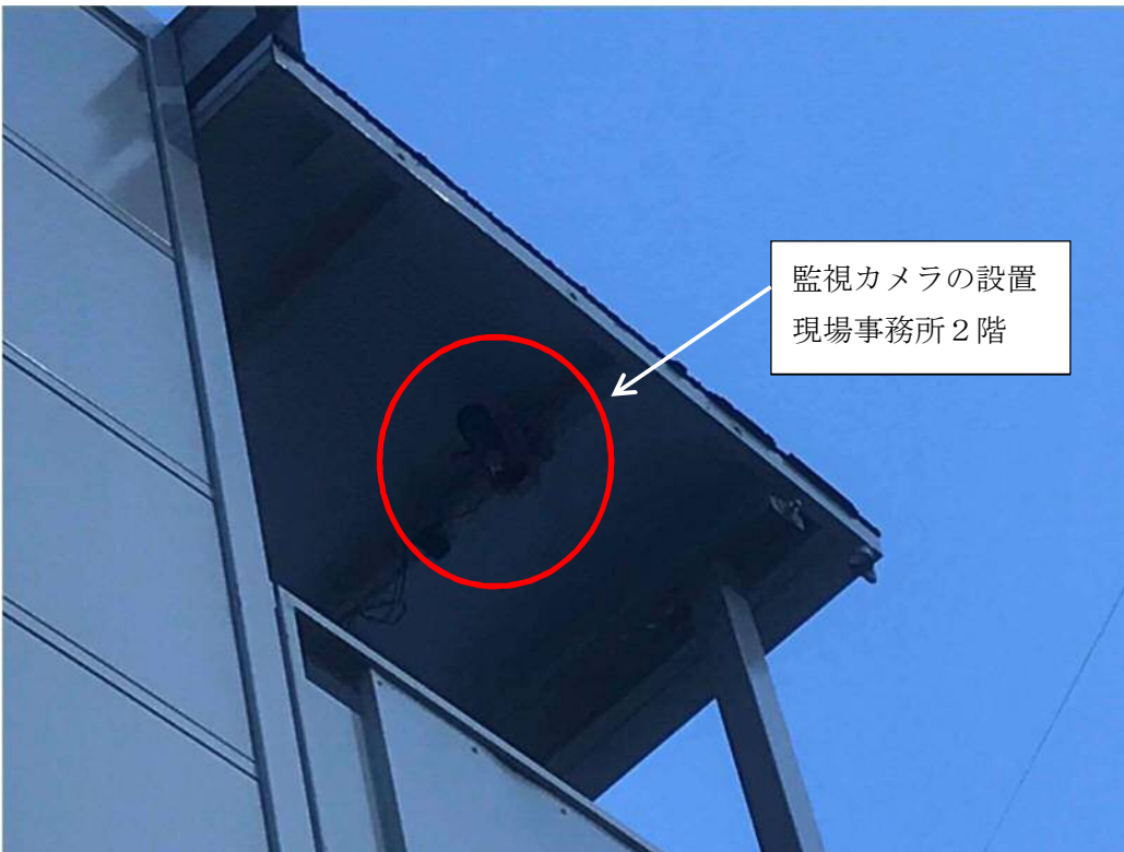
現場事務所に設置した監視カメラの写真
