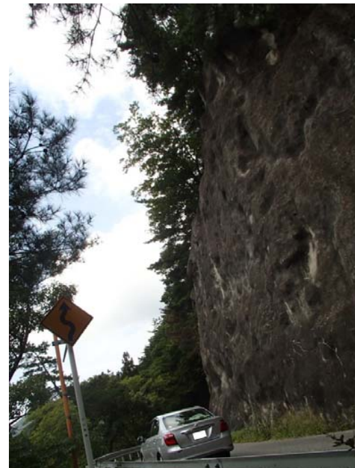
【写真②】 現道法面の状況 (落石発生源)
