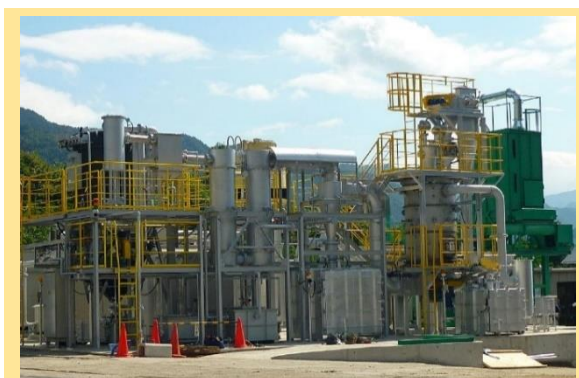
木質バイオマス小型ガス化発電装置（甲州市内）
