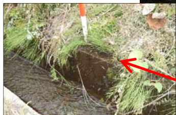
法尻からの漏水
