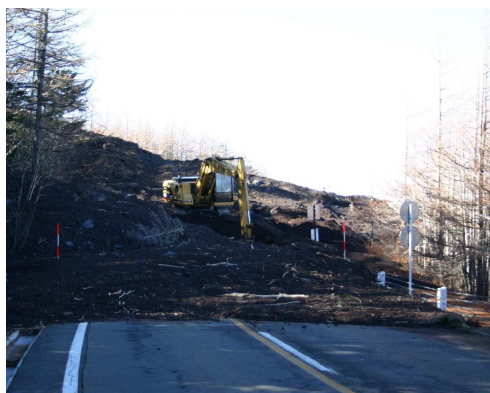
被災状況（H16/12/05 青草洞門）
