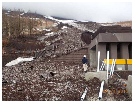
被災状況（H27/04/21 青草洞門）
