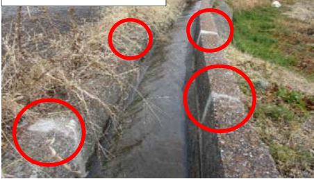
老朽化した水路
