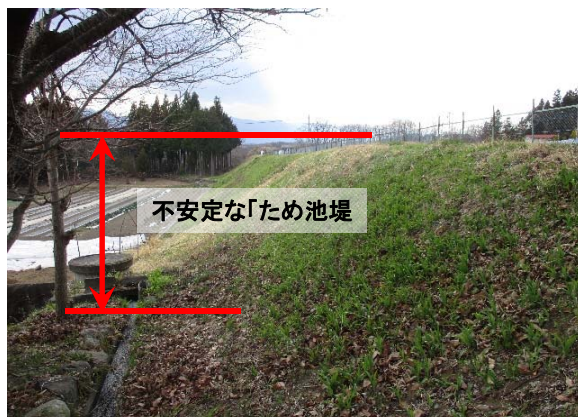
③ 堤体の安全性が低く崩壊が危ぶまれている。
