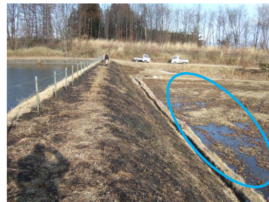
③ ため池直下の農地へ漏水し、決壊のおそれが高まっている。
