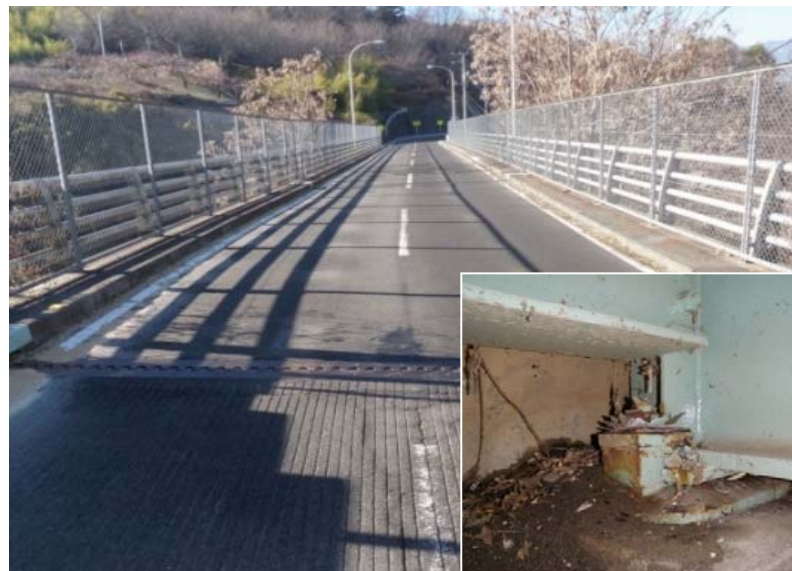
①一城橋全景 支承部の腐食
