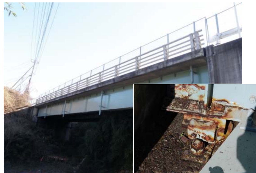
②奥ノ沢橋全景 主桁と支承部の腐食
