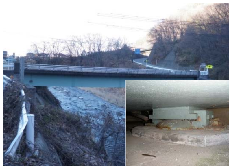
③川浦橋全景 支承部の腐食
