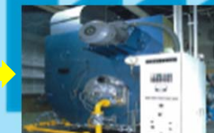
既設ボイラー
