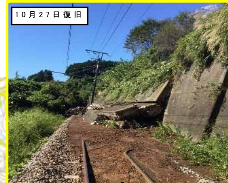
中央本線高尾～相模湖間 土留壁崩壊
