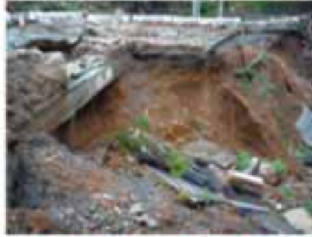
▲被災直後(被災施工②境沢橋手前)
