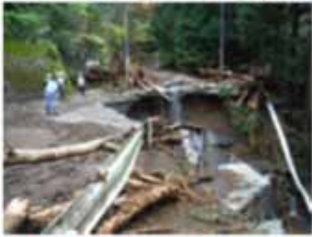
▲被災直後(国施工①津口沢橋手前)
