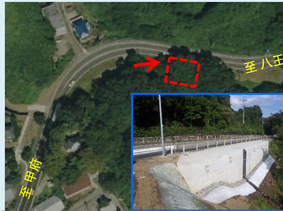
② 【R3補正対策工事】山梨県上野原市四方津地先 【防災対策】場所打法枠工等→R5.10完成
