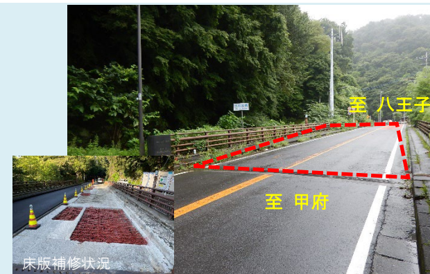
③ おおたるみ 大垂水橋 【橋梁補修】主桁補修、床版補修等
