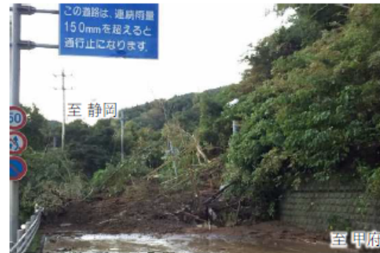
▲写真① 国道52号規制区間内の被災状況 (古屋敷地区) (令和元年10月)
