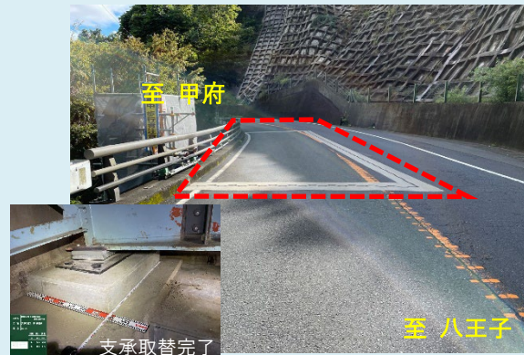
② だいちさんどう 第1棧道橋 【橋梁補修】主桁補修、支承補修等
