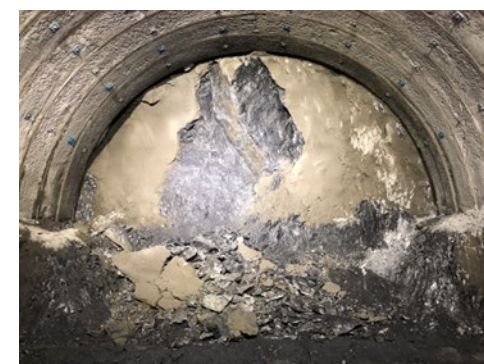
切羽崩落状況 写真:2024年8月 ※掘削進捗:約2,000m/約2,300m(2025.9)
