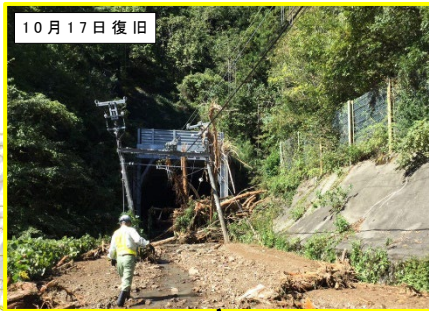
中央本線四方津～梁川間 土砂流入
