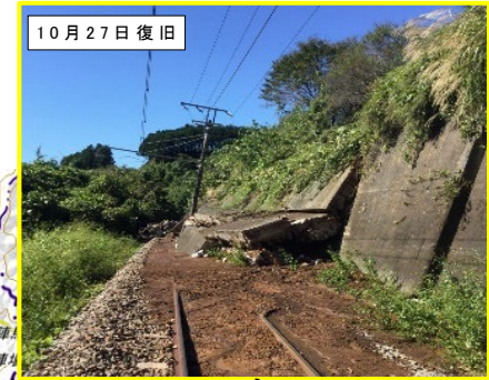
中央本線高尾～相模湖間 土留壁崩壊
