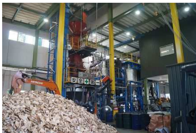
南部町バイオマス発電所
