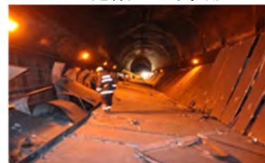
笹子トンネル天井板落下事故 (老朽化による事故)
