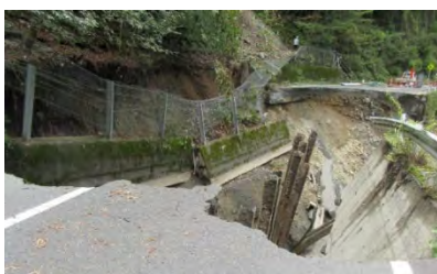
台風による土砂・道路崩落 (主要地方道 南アルプス公園線)
