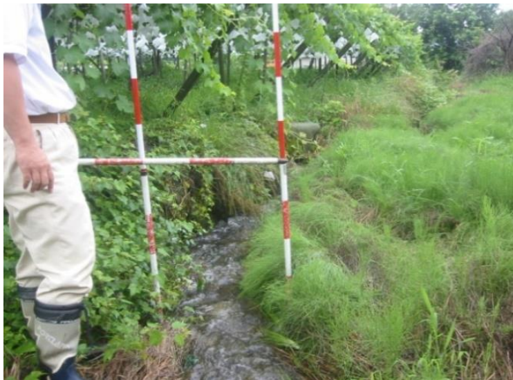
着工前 未整備のため、表土の浸食や排水不良が生じていた。
