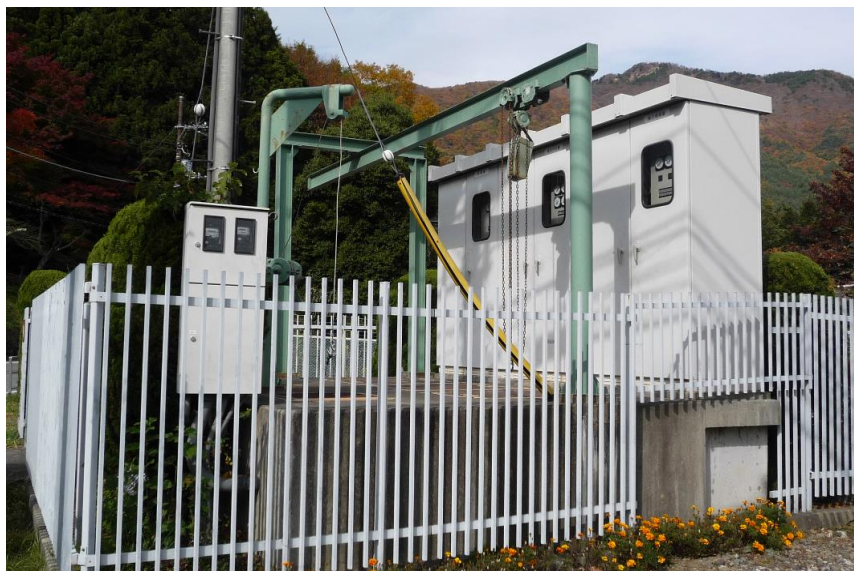
足和田中継ポンプ
