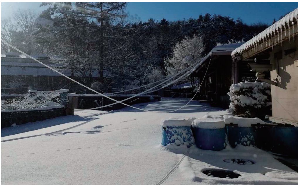
図4 着雪により垂れ下がった黒色PEライン
