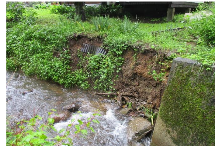
④ 水路法面が崩落し、近接する住宅への影響が懸念されている。
