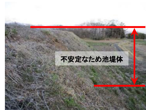
③ 観音第一ため池 堤体の安定性が確保されておらず地震時に堤体が決壊する危険がある。
