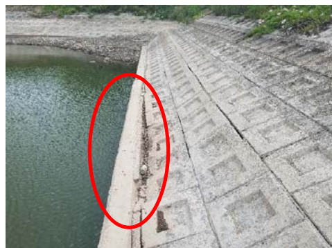
② 観音第一ため池 堤体の変形が確認されるなど、堤体が不安定な状態となっている。
