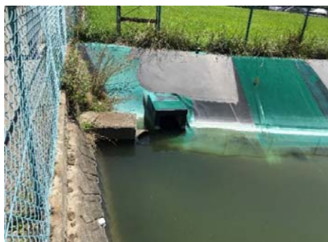
⑤ 下井出ため池 洪水吐の断面不足により、豪雨時には溢水し、ため池が決壊する恐れがある。
