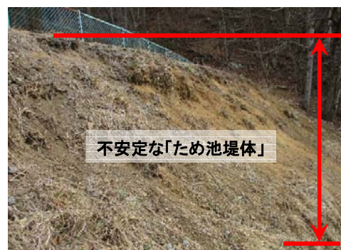
⑤ 堤体の安定性が確保されておらず地震時に堤体が決壊する危険がある。
