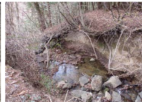
③ 洪水吐の破損状況。侵食が進み、堤体にも影響を及ぼしている。
