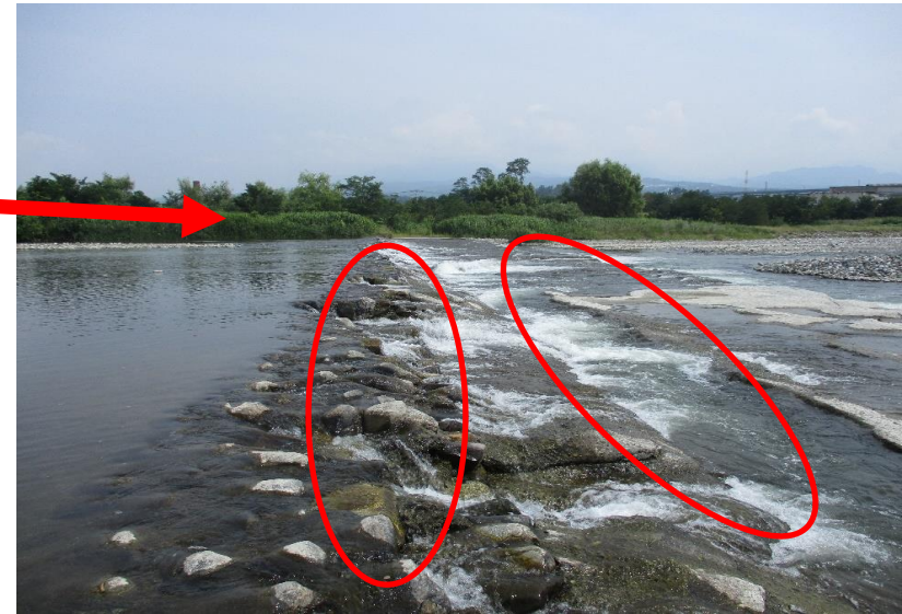
②床止工が流水により洗掘されている。
