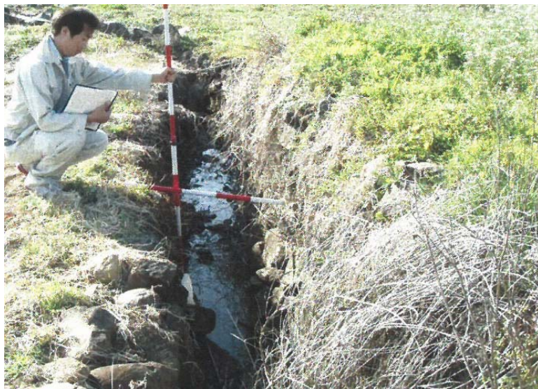
着工前 未整備のため、排水不良などが生じていた。
