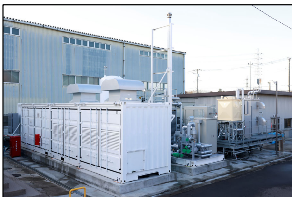
【500kWワンパックP2Gシステム全景】
